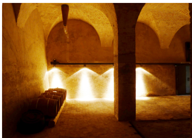
3. Abbazia di Praglia, cisterna sotto il chiostro pensile: l'intervento ha portato alla valorizzazione dello spazio dell'antica cisterna, ora trasformata in cantina di affinamento. Sono stati conservati i materiali originari rinvenuti: gli intonaci, la pavimentazione in cotto; è stato riattivato il sistema originario di raccolta dell'acqua piovana, collocato ai vertici dell'invaso quadrangolare, messo in evidenza dal sistema di tubazioni trasparenti in plexiglass
