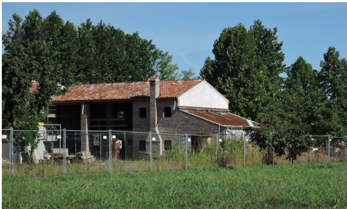
3. Il cantiere di recupero della casa colonica di via Bainsizza, destinata ad ospitare l'ecomuseo (foto G. Barbariol, 2017)
