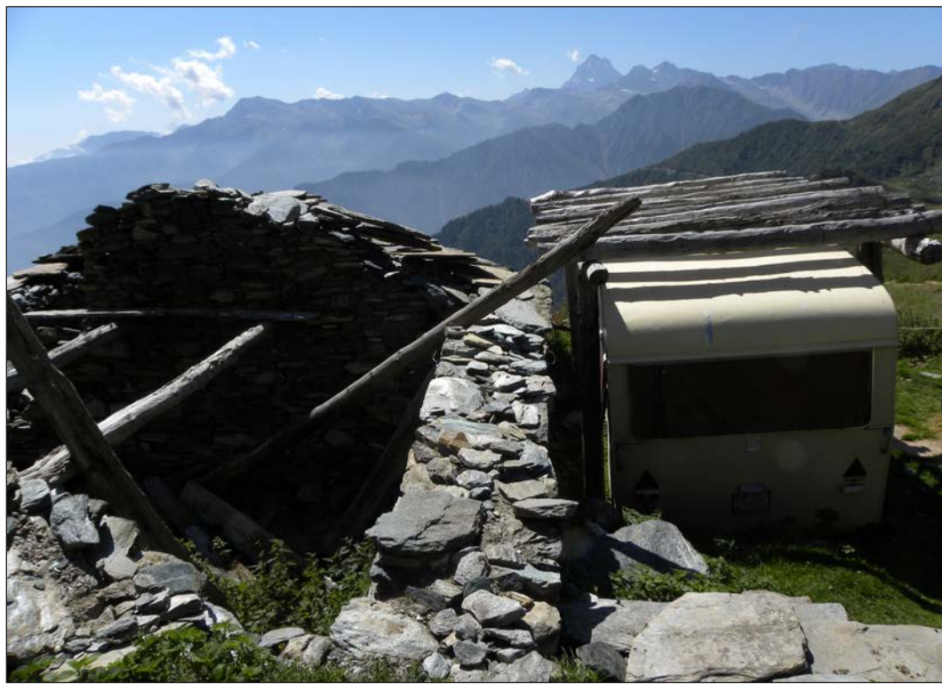
Fig. 1 (Battaglini et al.) – Mancanza di adeguate strutture in alpeggio pubblico. L'affittuario tenta di ovviare con mezzi di fortuna per le condizioni precarie delle abitazioni presenti (Alpe Giulian, Val Pellice, Torino) [Foto M. Verona]. Lack of adequate structures on public mountain pastures. The tenant tries to compensate with whatever he can find – here a caravan – since the onsite dwellings are now unusable (Alpe Giulian, Val Pellice, Torino) [Photo M. Verona].
