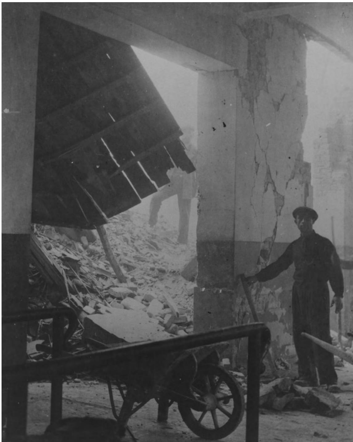
Sgombero delle macerie nella stazione della ferrovia Padova-Piazzola, nei pressi della stazione centrale. Padova. post 16 dicembre 1943.
